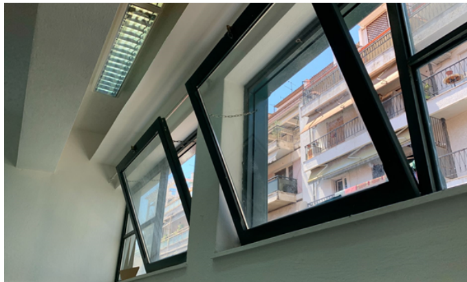
Εικόνα 1. Περιορισμός στον φυσικό αερισμό λόγω της σχεδίασης των ανοιγμάτων
