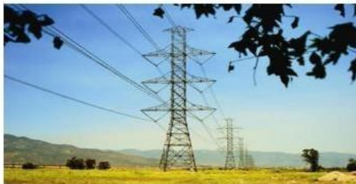
Hình 1-11. Đường dây dẫn điện trên không
