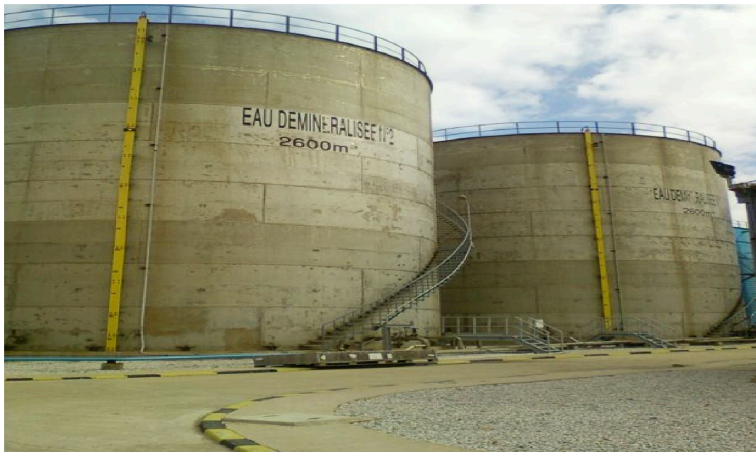
Figure 6 : Réservoir d'eau déminéralisée (la Centrale TAG comporte 2x2600m 3 )
