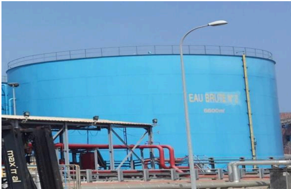
Figure 5 : Réservoir d'eau brute (la Centrale TAG comporte 2x 6600 m3)
