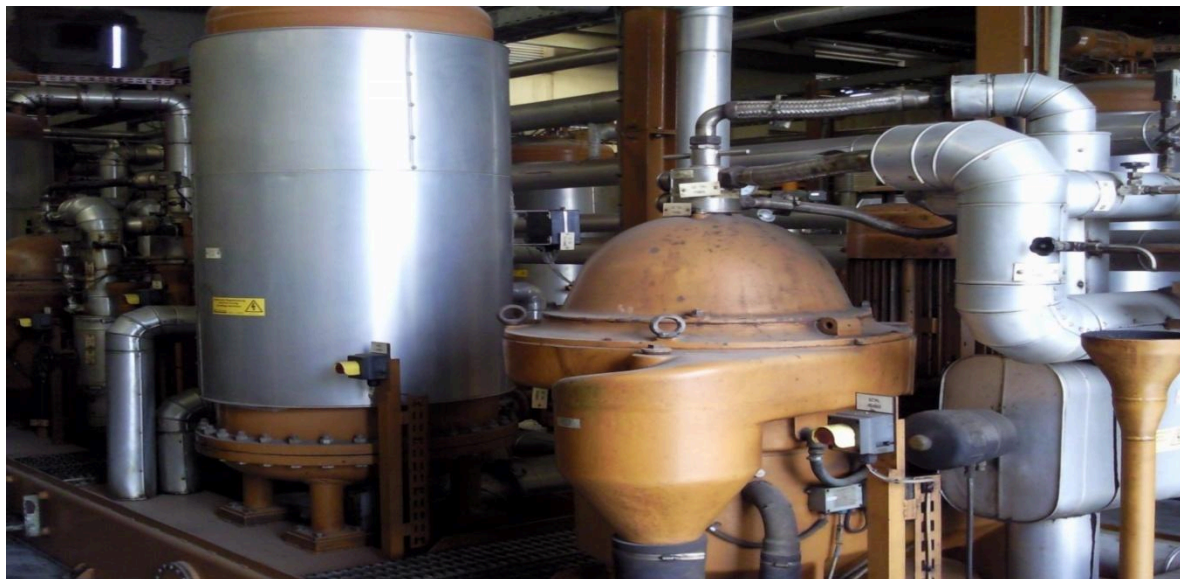
Figure 17 : poste traitement fuel
