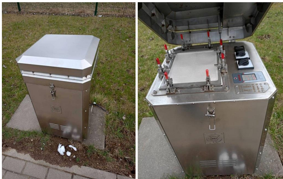
Фото 2 – фильтровентиляционная установка для отбора проб радиоактивных аэрозолей приземного слоя атмосферы
