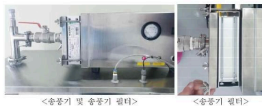
<송풍기 및 송풍기 필터>
