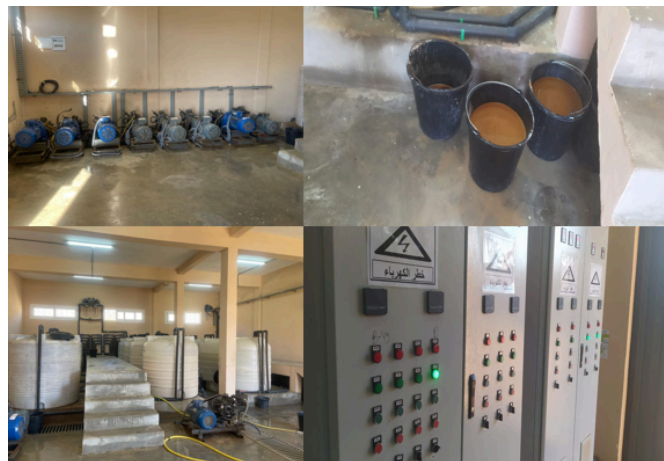
Figure 44: Le matériel de la station de traitement dans le domaine
