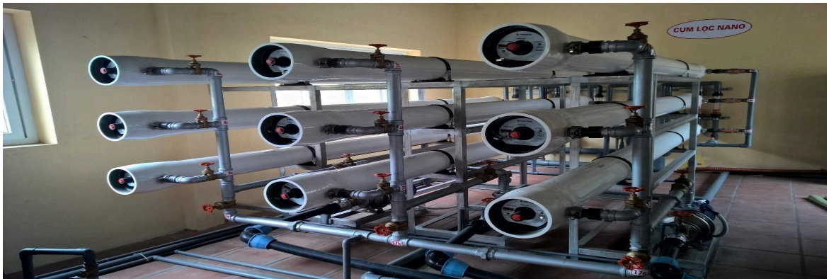
Cụm màng lọc cho việc tái sử dụng nước thải hầm lò mỏ than tại Công ty Than Hà Lâm - Quảng Ninh (Do Cty Môi Trường Việt-Sing thi công lắp đặt năm 2018-2019)
