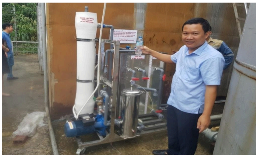
Lắp đặt mô hình NF quy mô phòng thí nghiệm tại trạm XLNT +75
