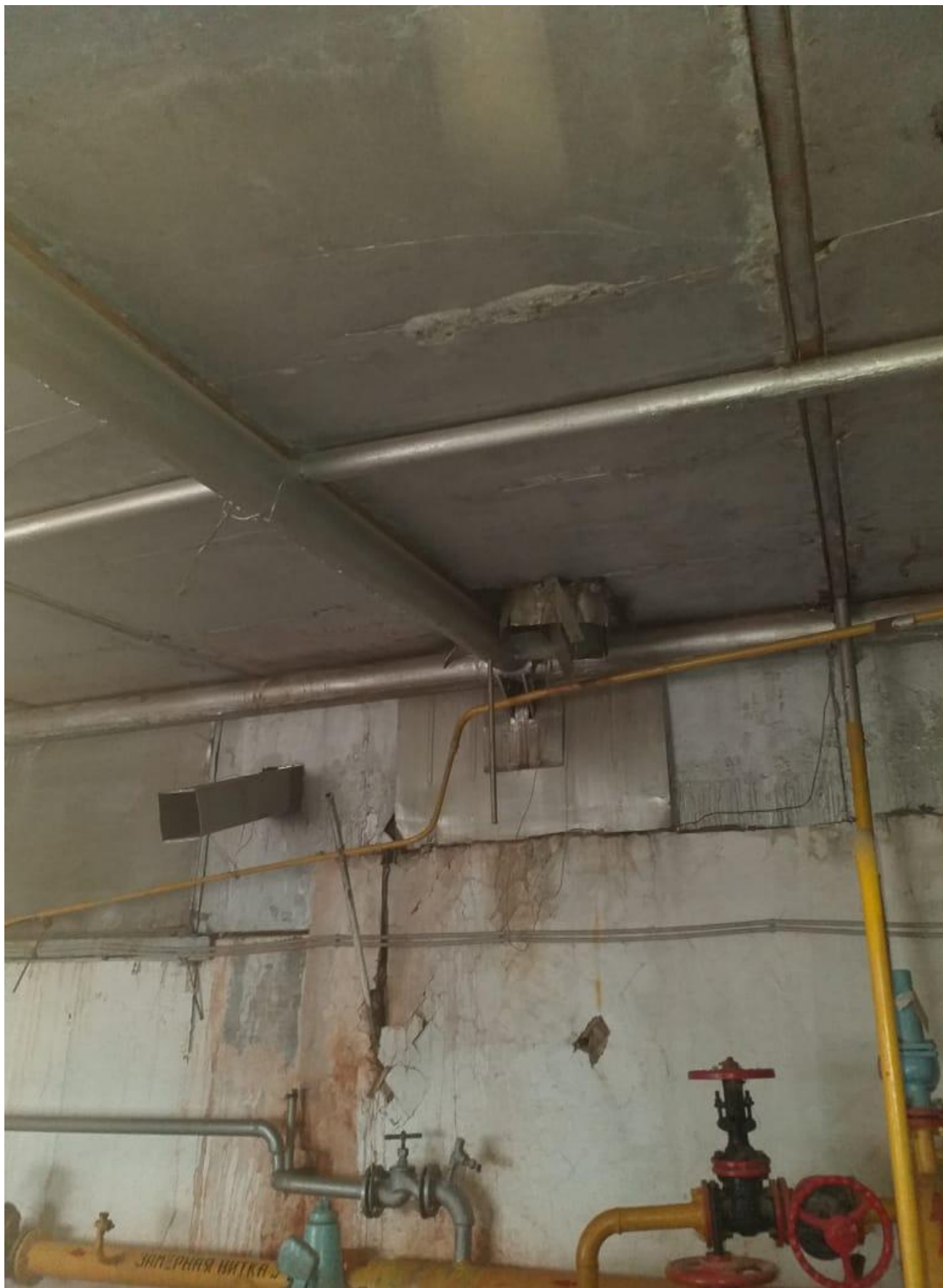
Помещение ГРП котельной №1, ул.Быстрицкого,9
