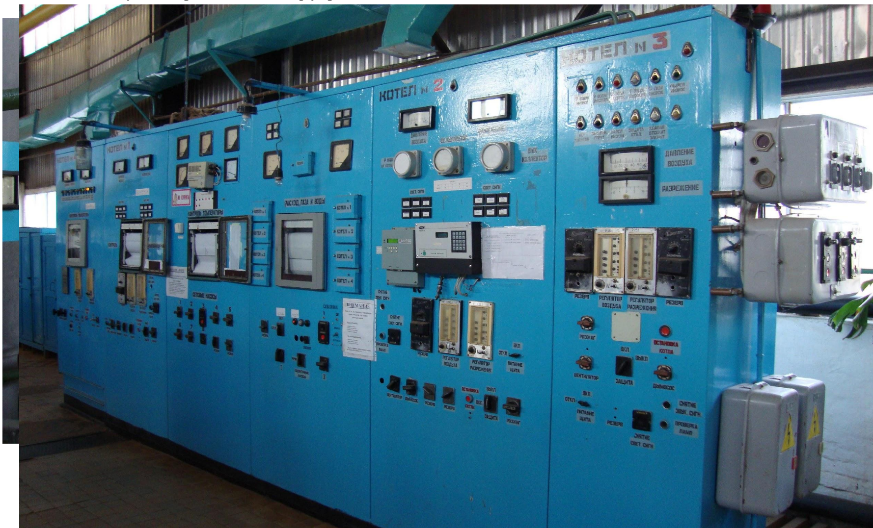
Котельная №1, ул.Быстрицкого,9. Шкаф управления.
