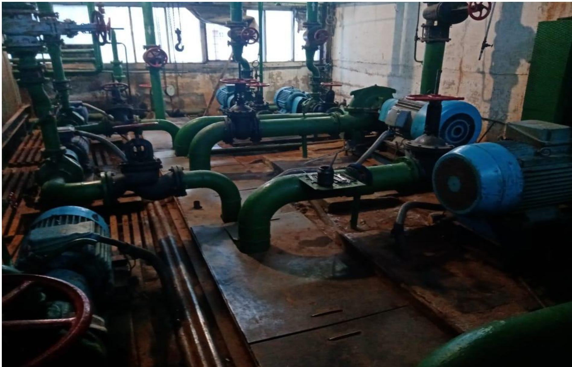
Котельная №1, ул.Быстрицкого,9. Насосное отделение.
