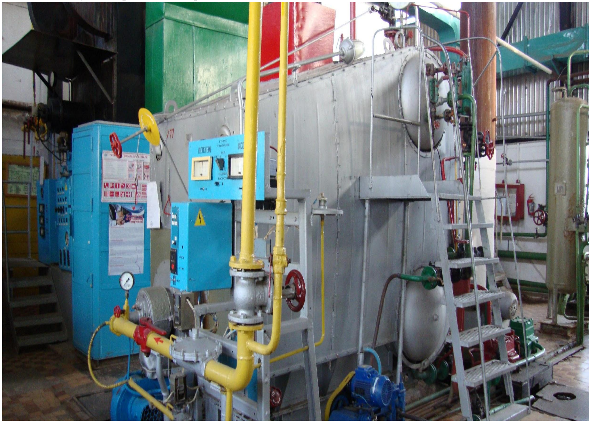
Котельная №1 ул.Быстрицкого,9. Паровой котел Е1/9.
