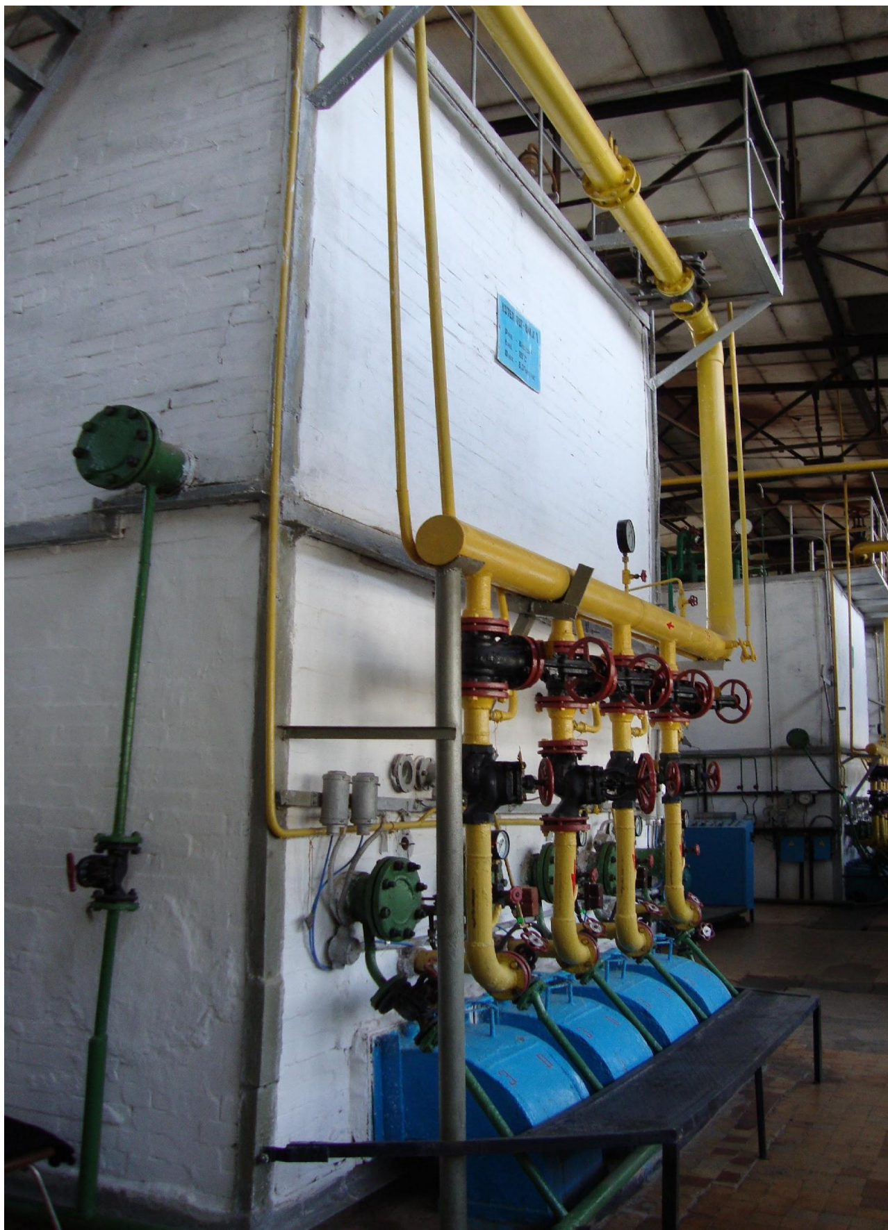
Котельная №1, ул.Быстрицкого,9. Водогрейный котел ТВГ 8М№1
