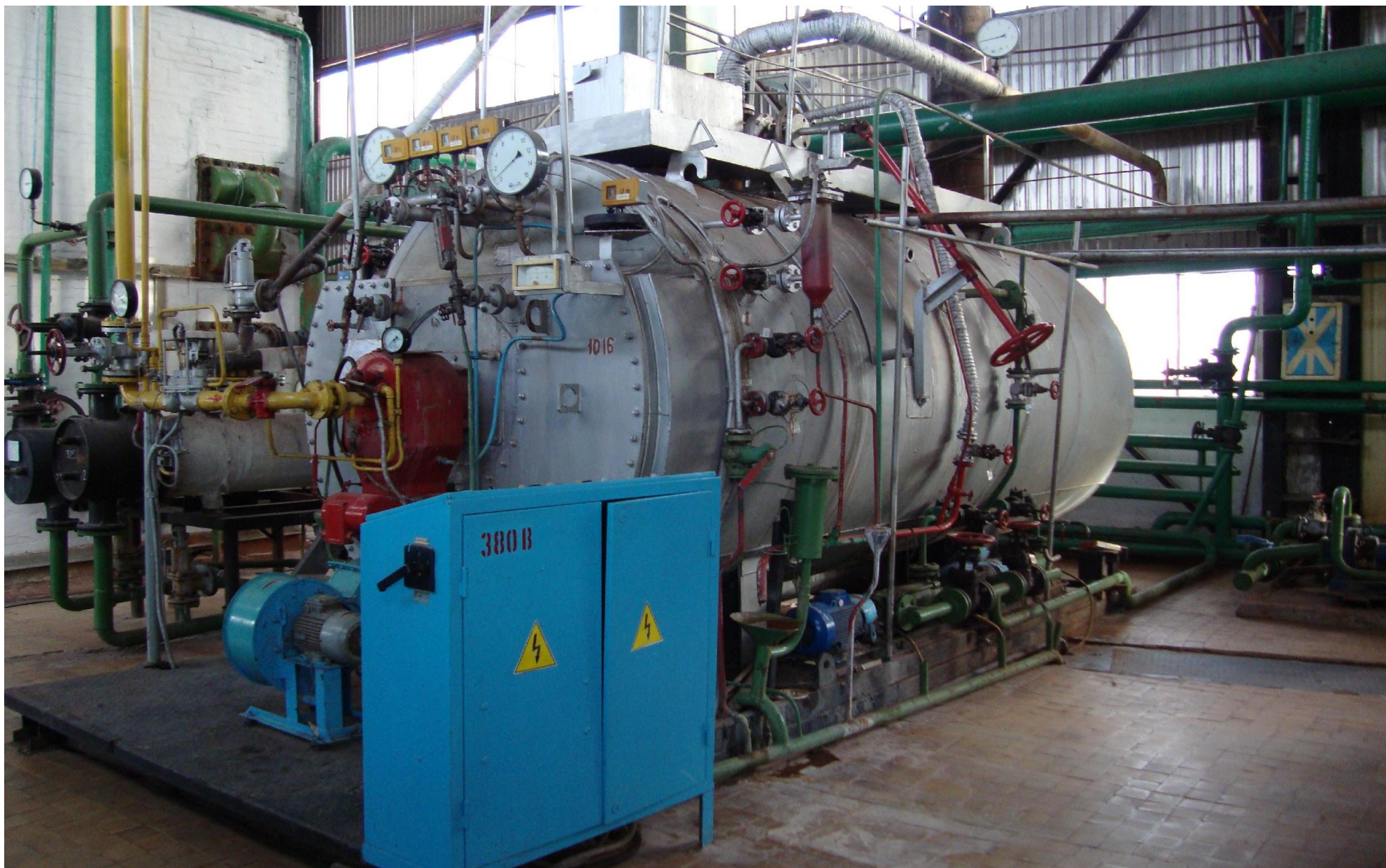
Котельная №1, ул.Быстрицкого,9. Паровой котел АВА2.
