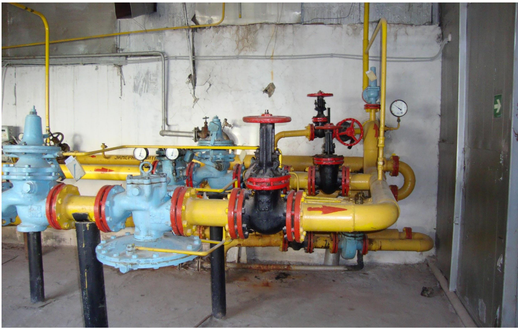
Котельная №1, ул.Быстрицкого,9. Помещение ГРП.
