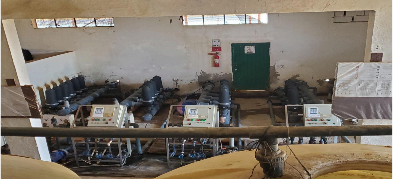
Figure 10: Station de fertigation vue à l'intérieur.
