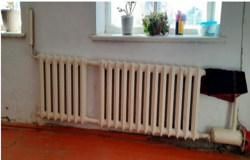
Фото 4. Система отопления школы. Чугунные радиаторы
