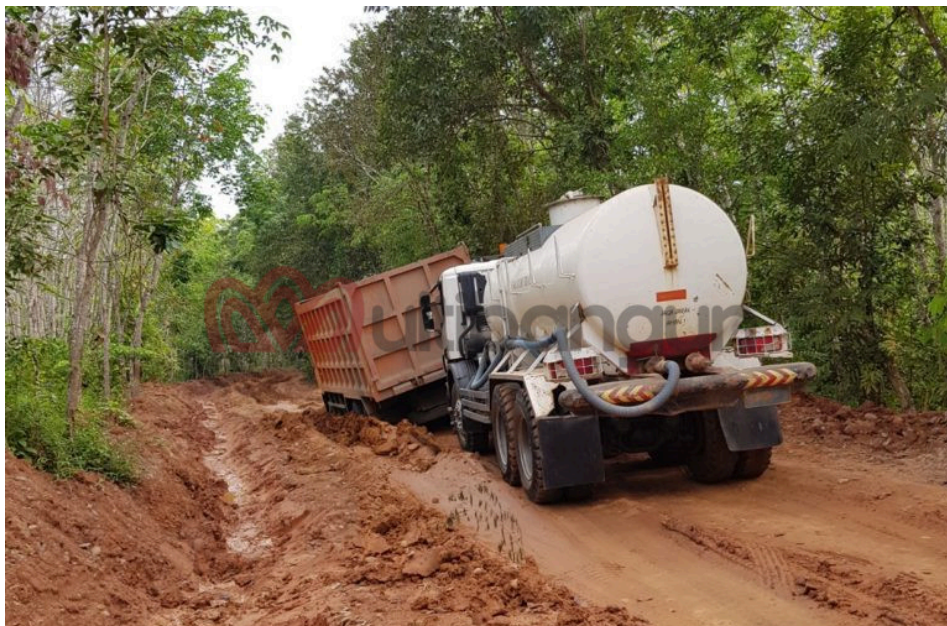
Gambar 1. Jalan Rusak Karena Daya Dukung Rendah
