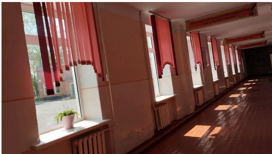
Фото 6. Тип установленных чугунных радиаторов в корпусе №1
