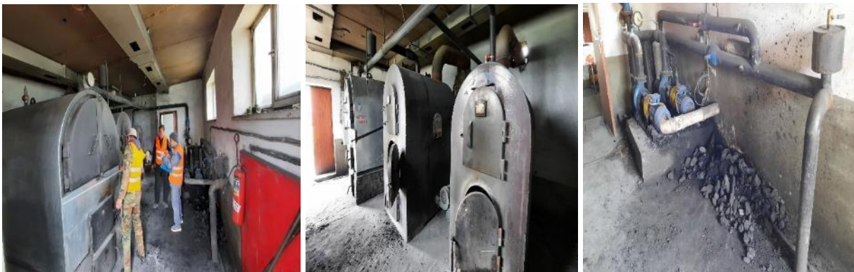
Фото 13,14,15 – Твердотопливная котельная и насосы.
