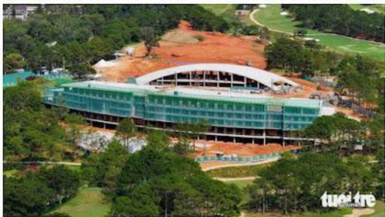
Tòa nhà không phép được xây dựng với 4 tầng nổi tạo nên khối tích đồ sộ - Ảnh: M.V.
