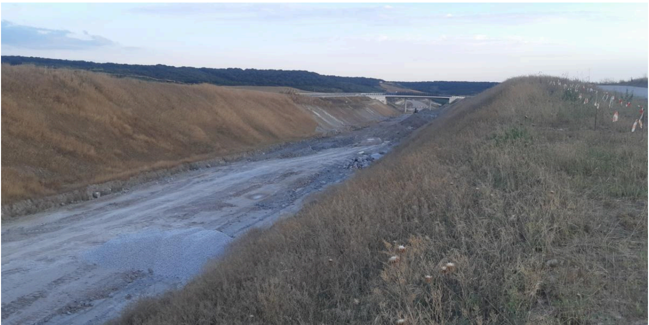
Efectos de las obras del TAV en el entorno de la Laguna del Juncal
