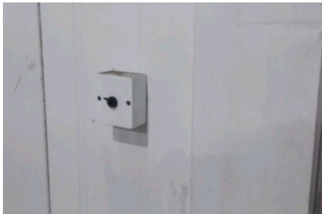
Botão de emergência interno na câmara fria
