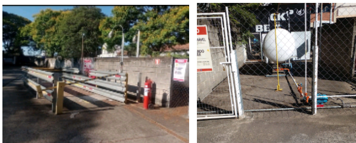
Área de reservatório e abastecimento de GLP
