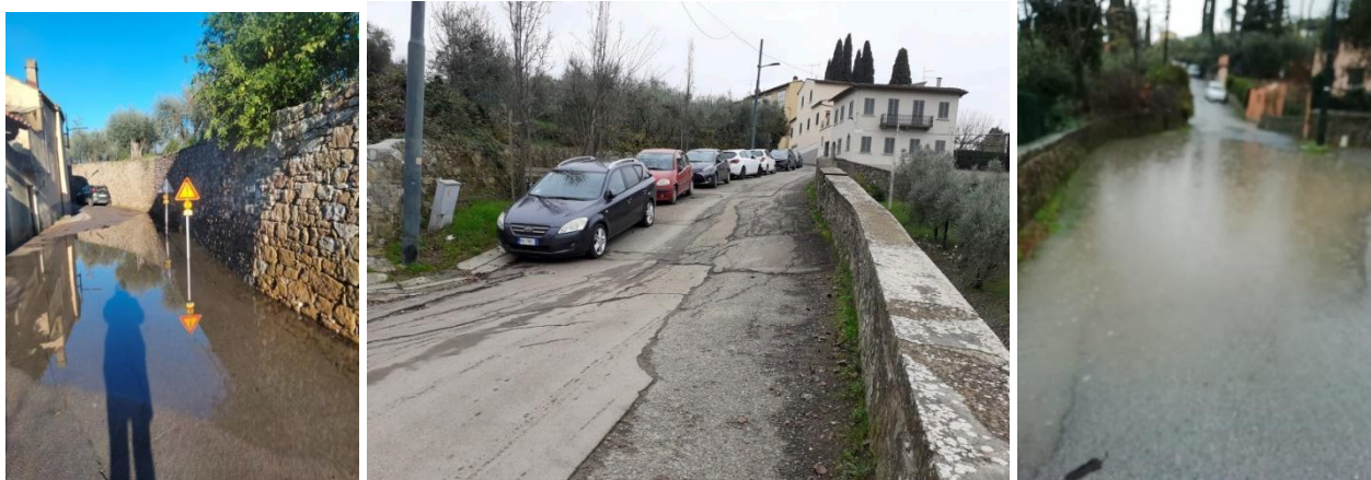
Via del Rossellino (i laghi e lo smottamento con crolli e distruzione del manto)
