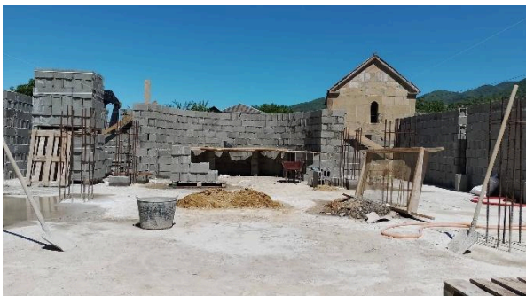
სურ. 1–2. ზღუდერი, ძველი ტაძრის ადგილას დაწყებული თანამედროვე მშენებლობა, 2026 წლის 13 ივნისის მდგომარეობით, ფოტო: თამთა დოლიძე.
