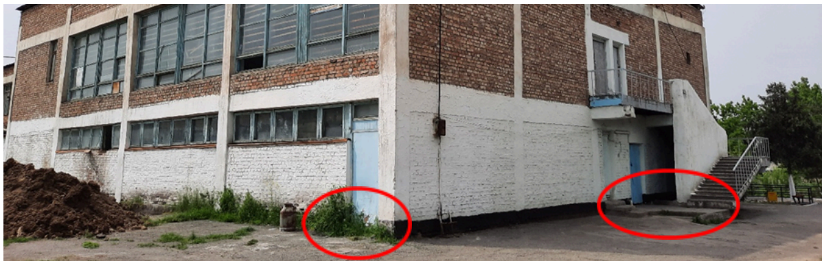
Фото 15. У входов в спортзал пандусов не имеется (блок №1-5)
