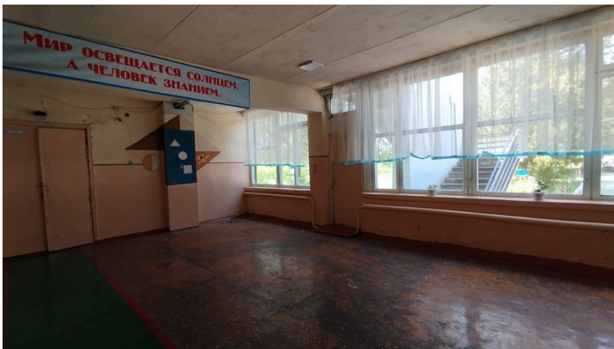
Фото 9. Самодельная система отопления в холлах из стальных труб диаметром 150 мм
