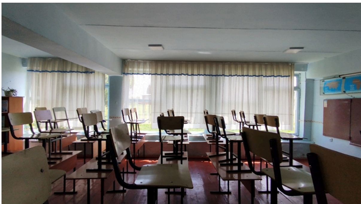
Фото 11. Вентиляционные шахты и воздуховоды в учебных классах отсутствуют
