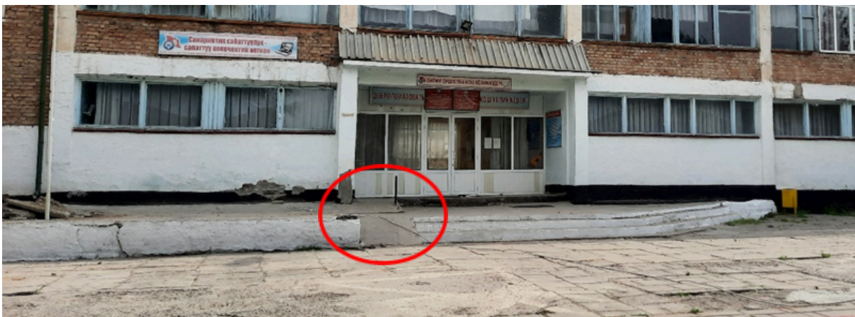
Фото 14. У главного входа в блоке № 1-3 пандус не соответствует требованиям
