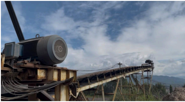
Gambar 3. Mesin penggerak conveyor belt dan conveyor belt pada unit stone crushing plant
