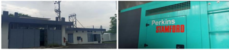
Gambar : Sarana kelistrikan genset
